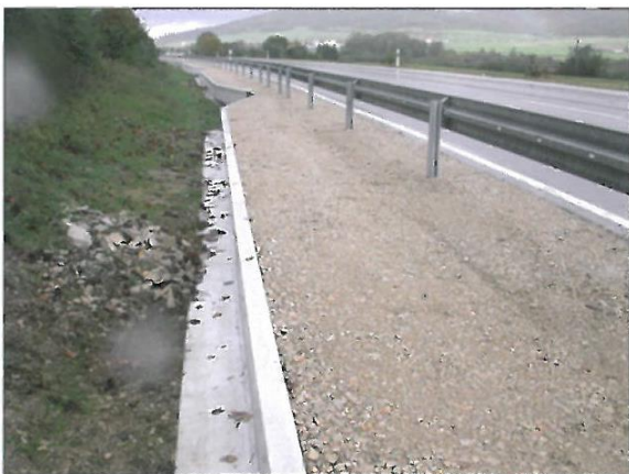
圖 7：人工建造的兩棲動物保護圍欄以及固定在路面的過接通道
